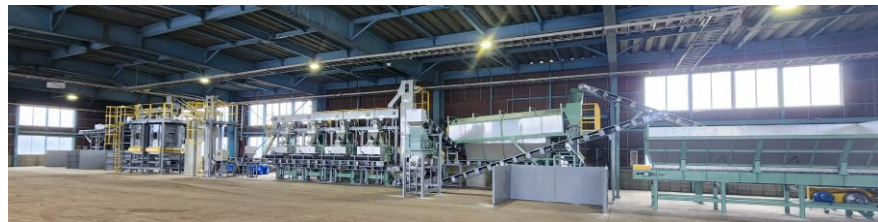
ペレット肥料製造装置
